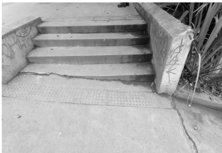
Figura 5 - Escada encontrada na via pública sem corrimão
